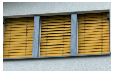
Beschädigte, provisorisch reparierte Storen am Schulhaus.
