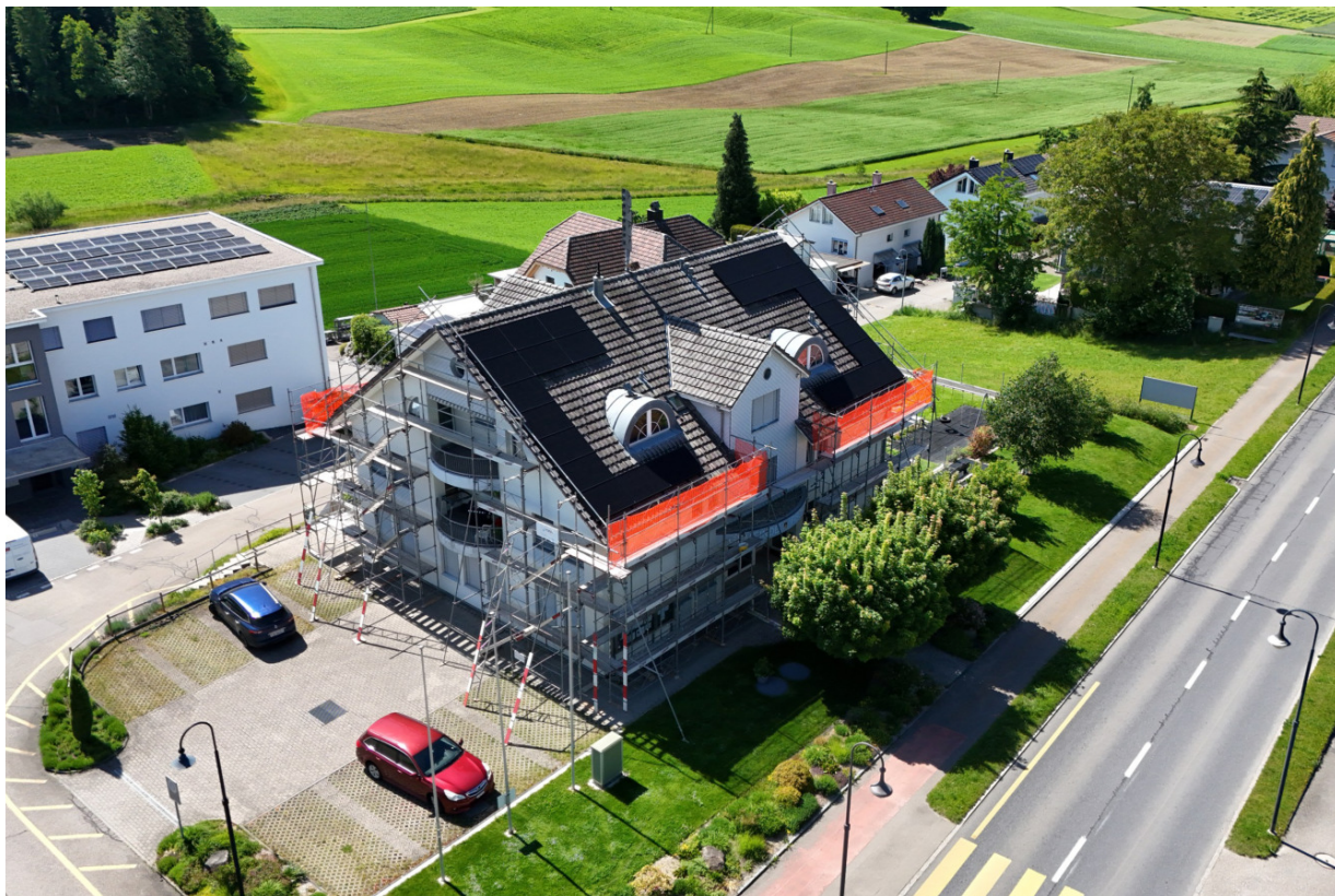
Das Gemeindehaus wurde saniert und mit Solaranlage und Batteriespeicher ausgestattet.
