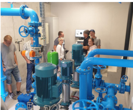
Am 27. August 2022 war der Gemeinderat zu Besuch beim neuen Quellwasserpumpwerk Loch.
