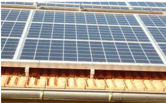
Durchzug - natürliche Kühlung der Panels
